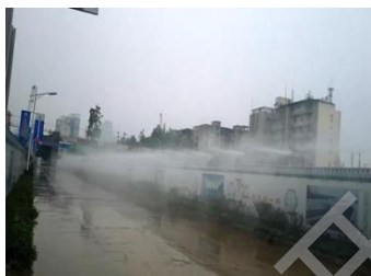
图 4.3 施工区喷淋及排水系统
